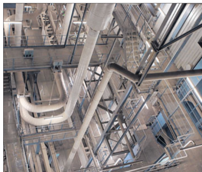
Sehr hoch, sehr warm: Auf vier Etagen liefern Brenner die Energie, um die Turbine anzutreiben.
